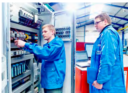
Einrichtung der elektronischen Steuerung
