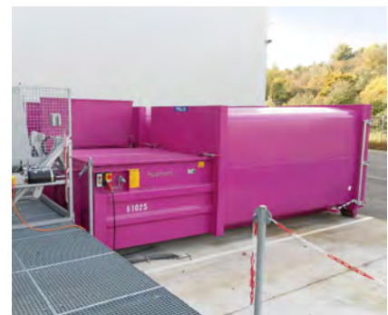
SPB SEL-E mit stationärer HKV auf Laderampe
